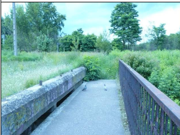
Rejon ul. Rzeźnickiej - zaniedbany most na rzece Stradomka.
