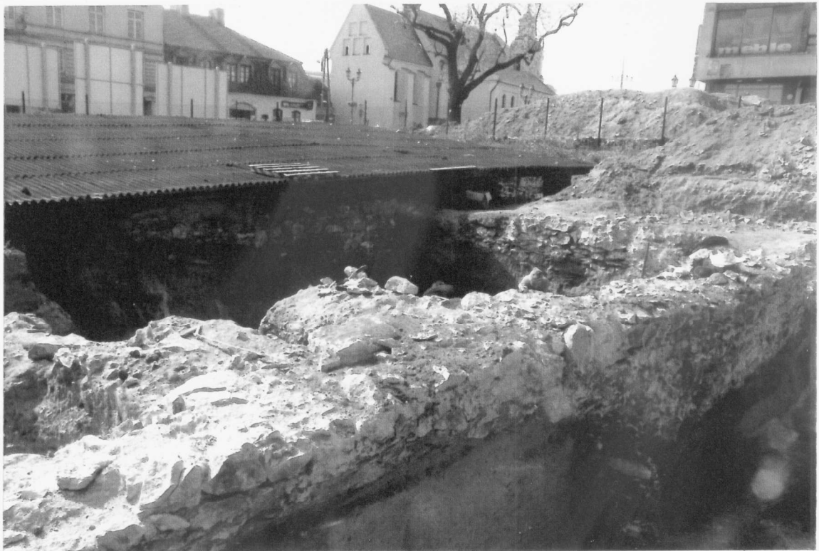
il. 9, Częstochowa, Stary Rynek, odstawięte mury parterowego budynku dobudowanego do starszego obiektu (nakryty daszkiem), widoczne różnice w głębokości fundamentowania fot. WN. 2009r.
