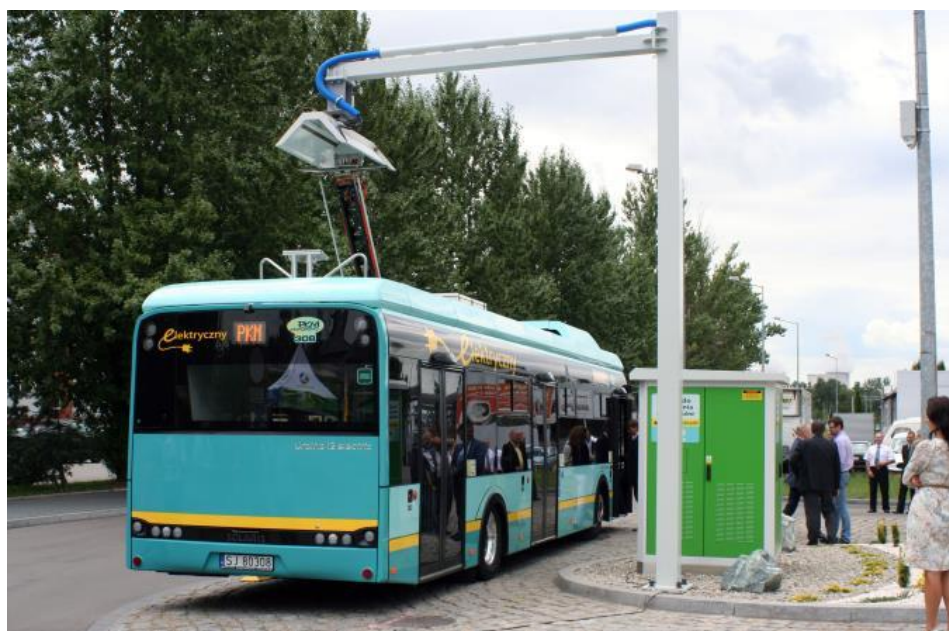
Rysunek 5 Pantografowa stacja ładowania autobusów elektrycznych w Jaworznie, źródło: https://www.transport-publiczny.pl/img/jaworznostacja1.jpg_678-443.jpg
