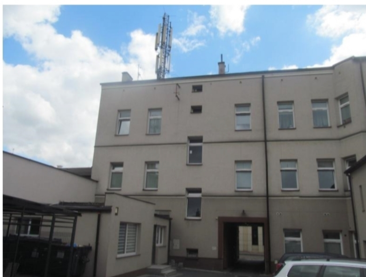
Zał. nr 1: Widok ogólny instalacji radiokomunikacyjnej.
