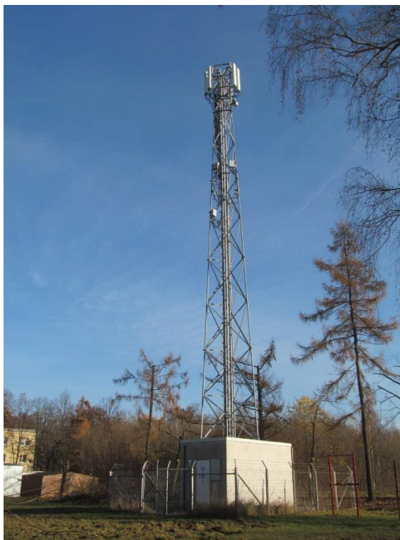
Zał. nr 1: Widok ogólny instalacji radiokomunikacyjnej.
