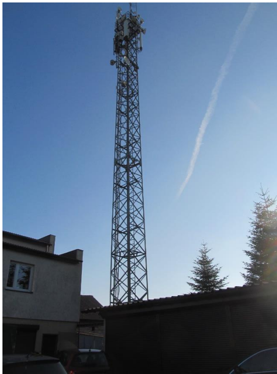
Zał. nr 1: Widok ogólny instalacji radiokomunikacyjnej.
