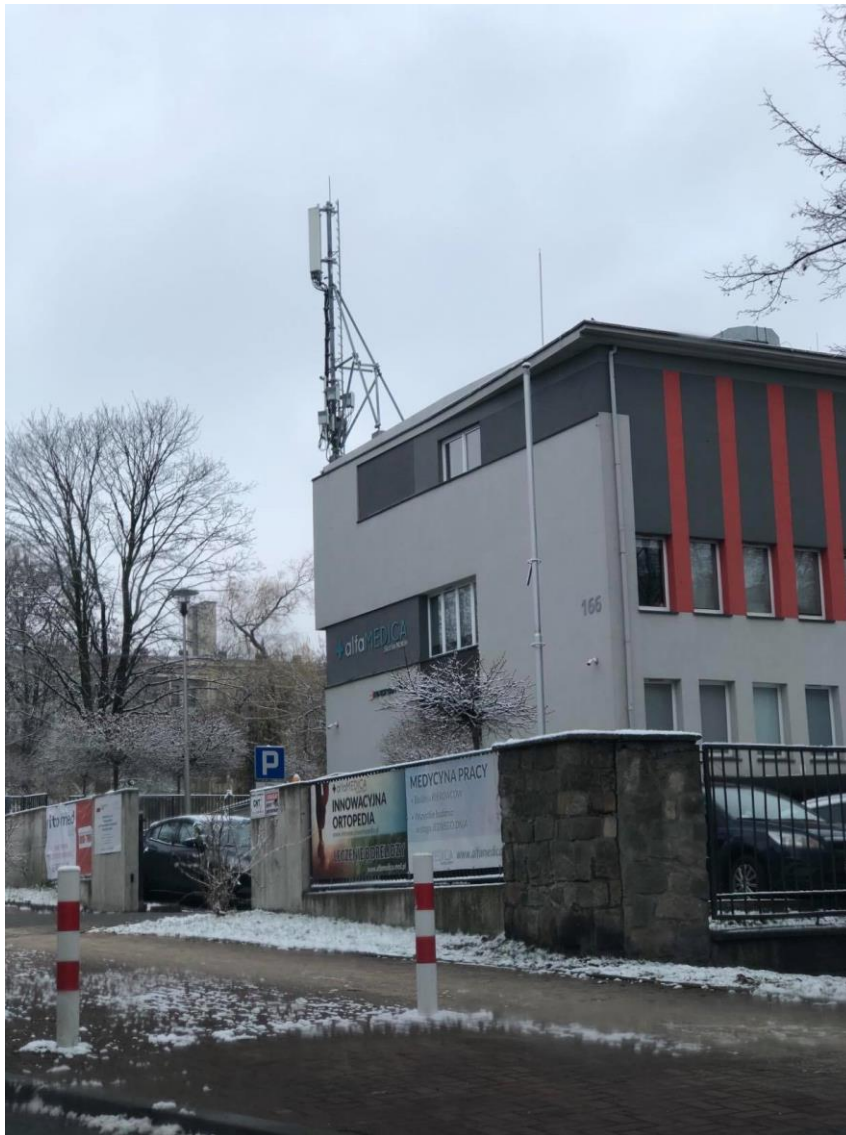
Zał. nr 1: Widok ogólny instalacji radiokomunikacyjnej.
